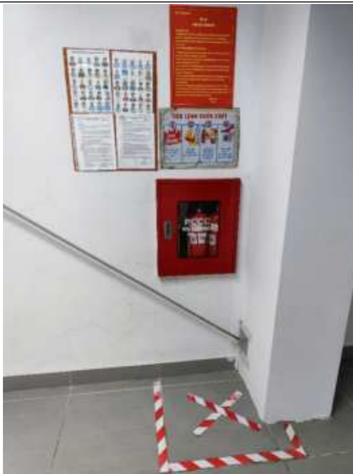
Hình 3.4: Bình chữa cháy được đặt tại các vị trí trong Công ty
