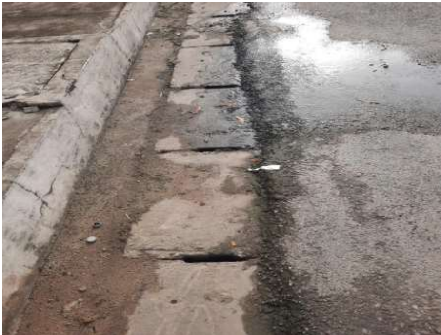
Hình 3.2. Hình ảnh mương thu gom nước mưa
